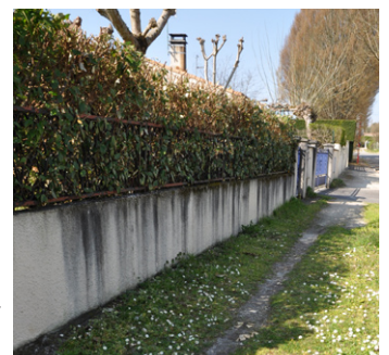
Mur sans couvertine : coulures salissant l'enduit à terme
