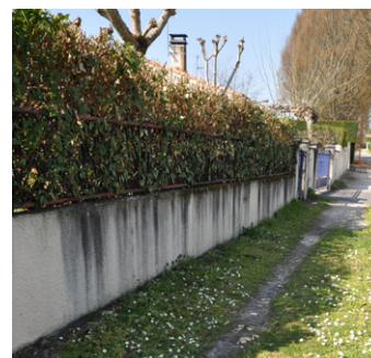
Mur sans couvertine : coulures salissant l'enduit à terme
