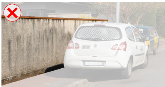
Mur toute hauteur, un manque de végétation et de perméabilité avec la rue, coulures qui salissent le mur
